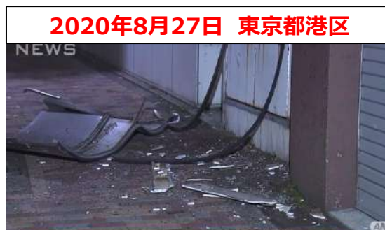
2020年8月27日 東京都港区 雑居ビルの階段一部が崩落 東京・港区
