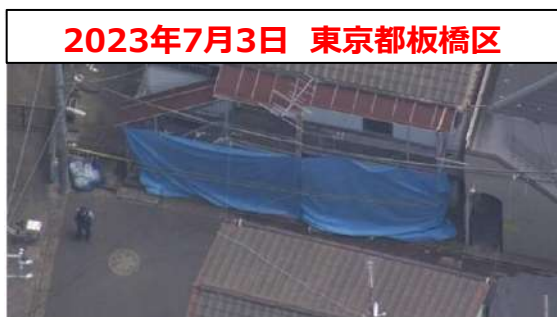
2023年7月3日 東京都板橋区 東京 板橋 アパート2階外廊下の床抜け 2人 転落 命に別状なし
